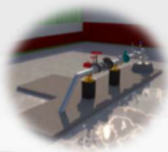
Tren de piezas y punto de extracción de agua potable.
